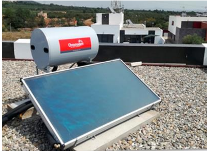
Placa solar y acumulador para calentar el agua sanitaria
