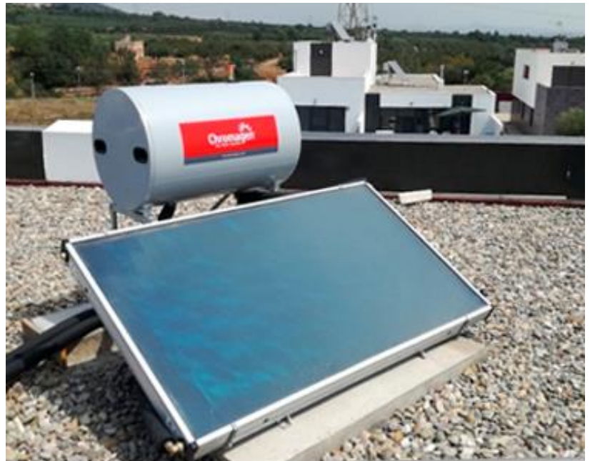
Placa solar i acumulador per calentar l'aigua sanitària
